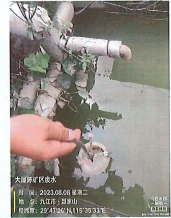
照片 28: 大屋陈矿区废水
